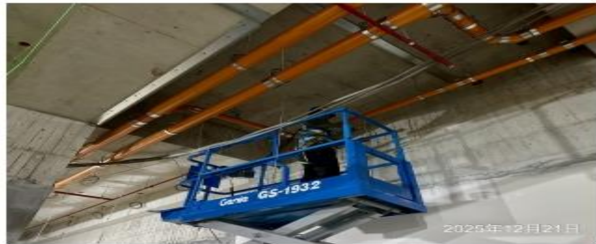
說明：排水管配管。
